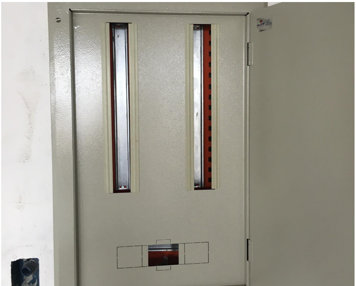
Figura 19: Quadro distribuidor vazio. (Fonte: Dos Autores 2020).
