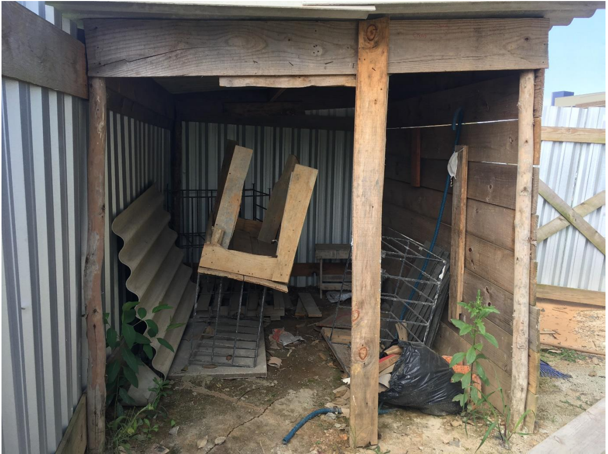
Figura 24: Possível depósito de obra. (Fonte: Dos Autores 2020).
