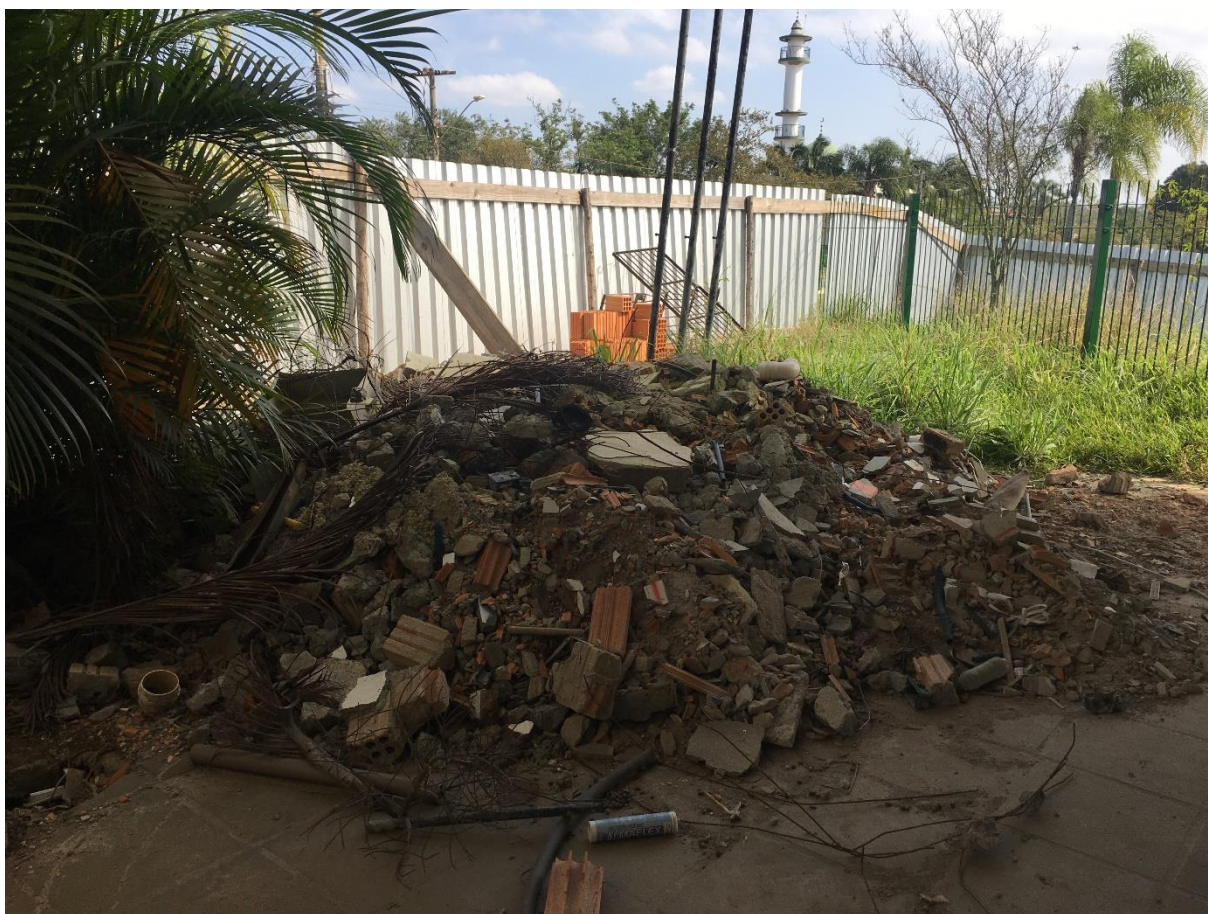
Figura 23: Entulhos espalhados. (Fonte: Dos Autores 2020).
