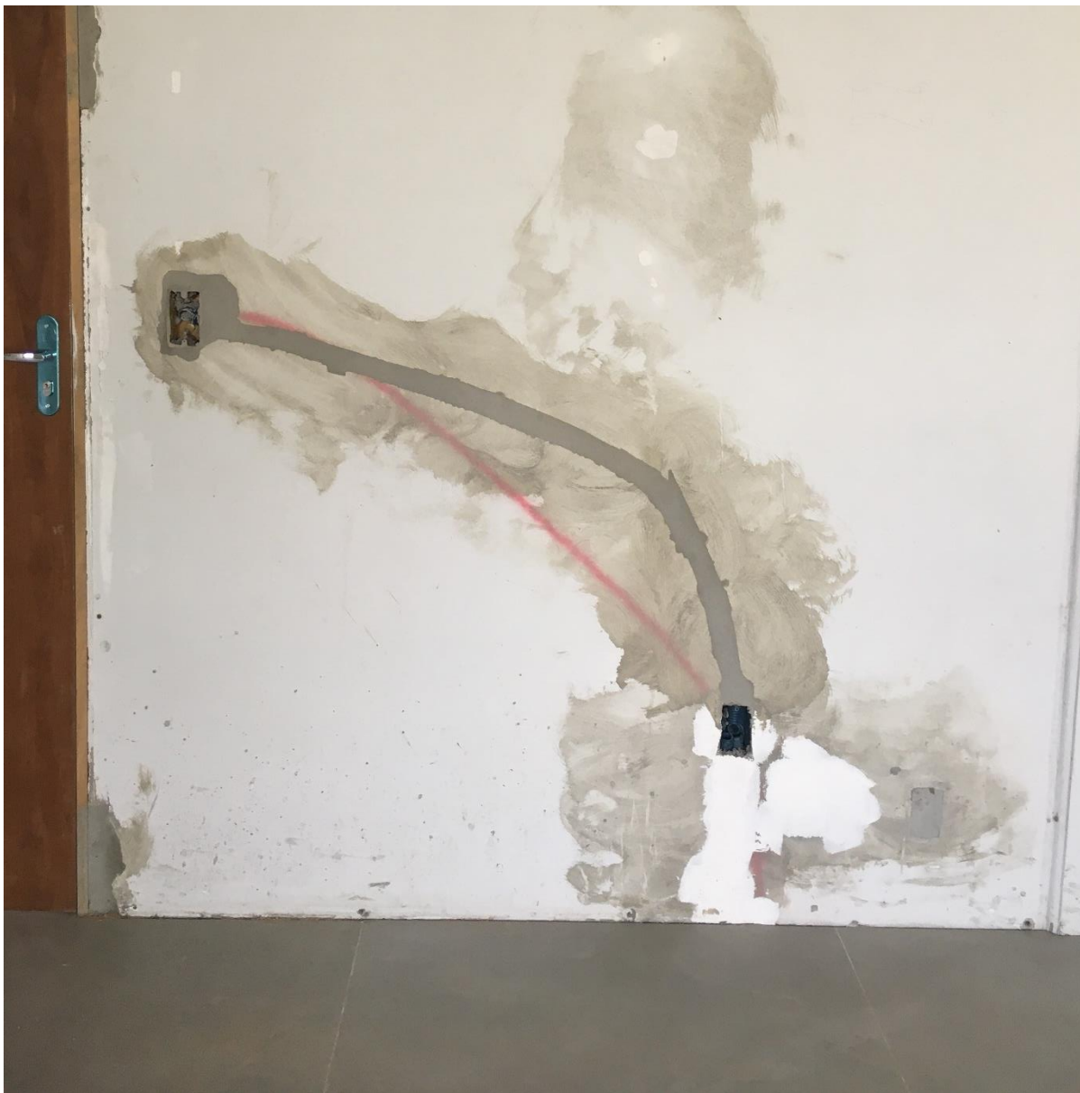
Figura 17: Eletrodutos embutidos. (Fonte: Dos Autores 2020).
