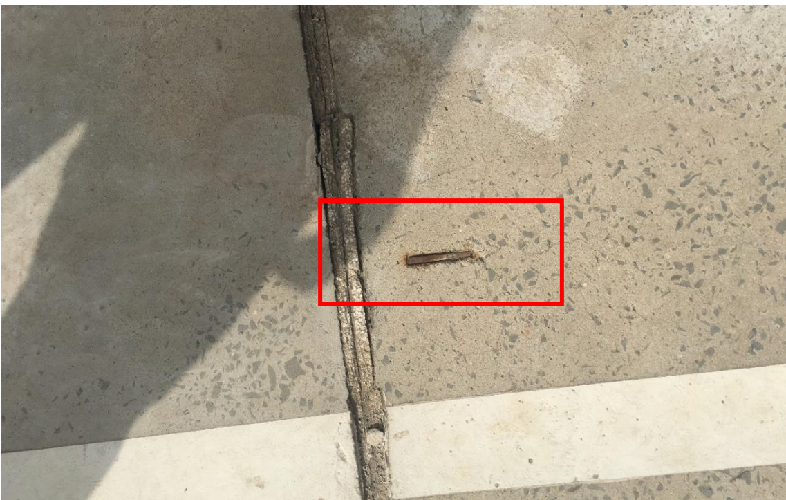
Figura 16: Armação aparente no chão da quadra. (Fonte: Dos Autores 2020).
