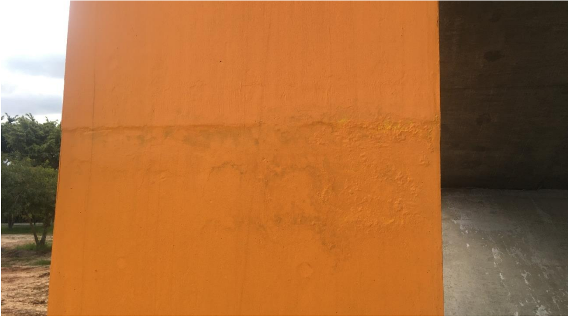
Figura 25: Tinta amarela inchada no pilar do palco (Fonte: Dos Autores 2020).
