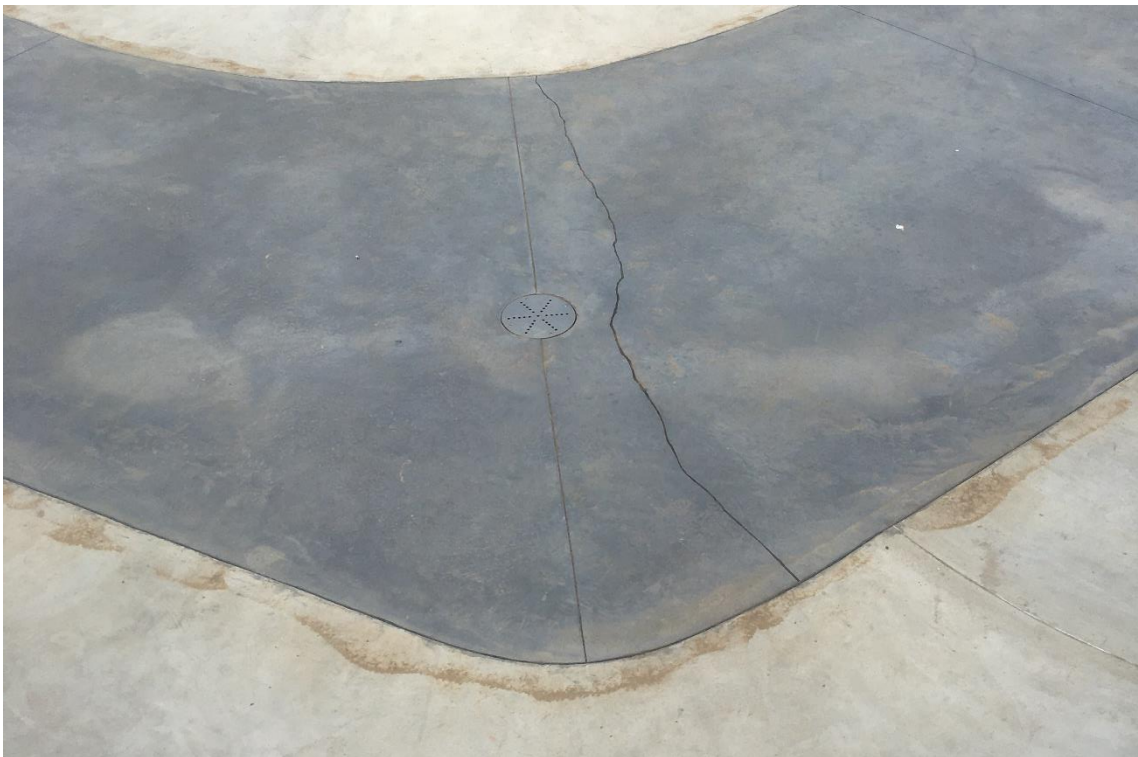
Figura 30: Fissura no concreto. (Fonte: Dos Autores 2020).
