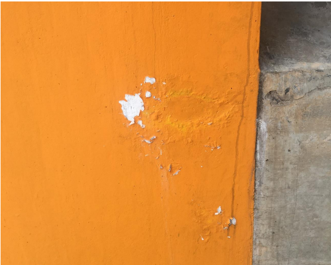
Figura 26: Tinta descascando. (Fonte: Dos Autores 2020).
