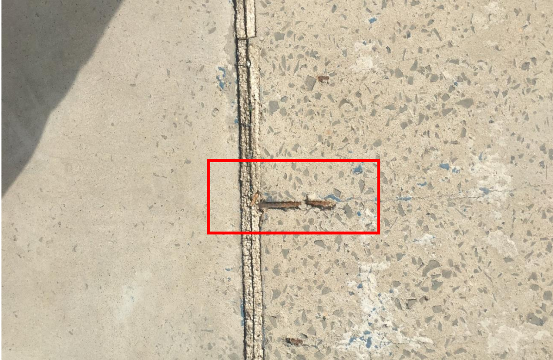
Figura 15: Armação aparente no chão da quadra. (Fonte: Dos Autores 2020).
