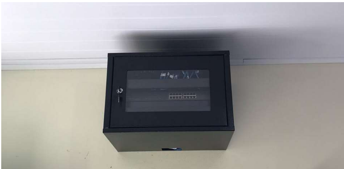
Figura 15: Rede lógica instalada. (Fonte: Dos Autores 2020).
