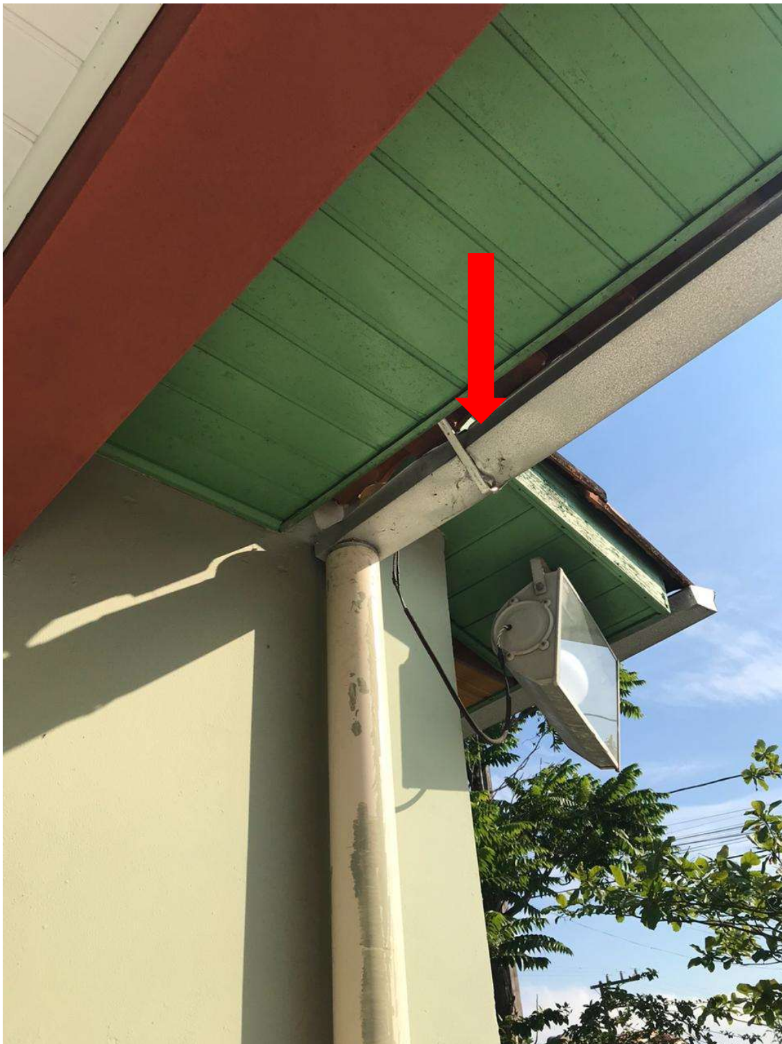
Figura 8: Defeitos na soldagem da calha. (Fonte: Dos Autores 2020).
