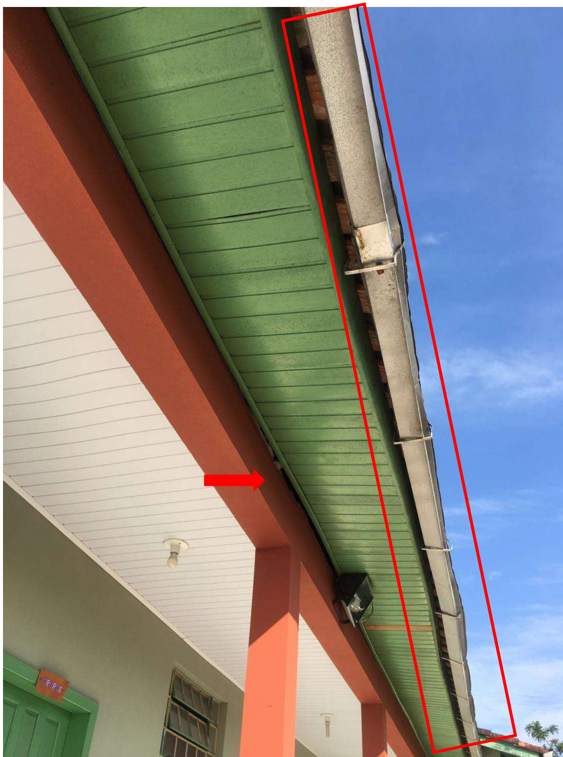
Figura 7: Beiral com forro e calha totalmente desalinhados. (Fonte: Dos Autores 2020).
