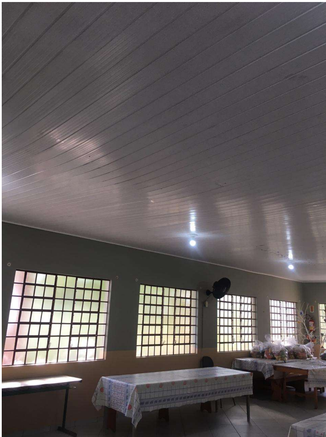
Figura 12: Forro com abaulamento. (Fonte: Dos Autores 2020).
