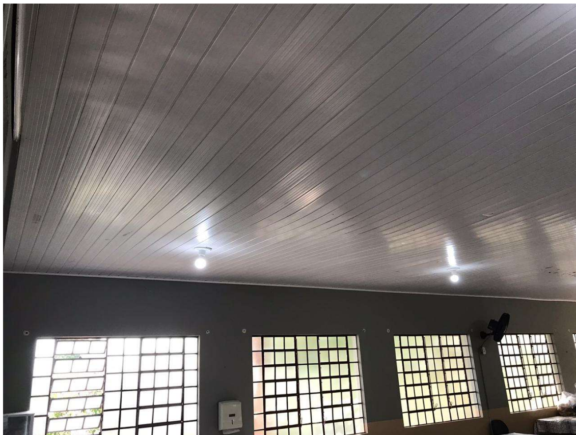
Figura 11: Forro rebaixado pelo reservatório de água. (Fonte: Dos Autores 2020).
