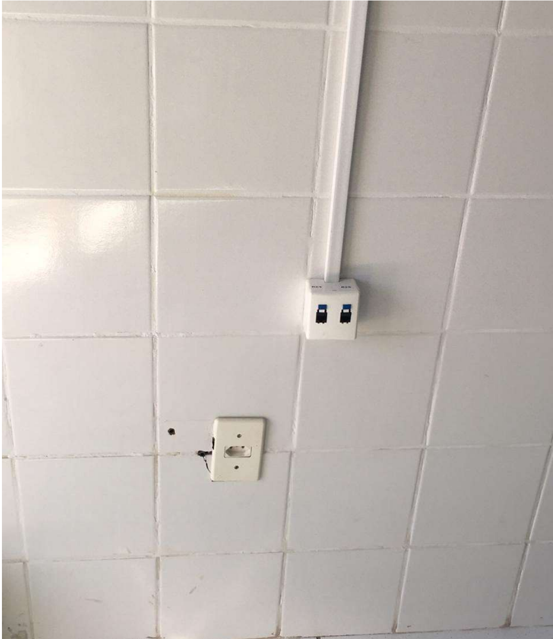
Figura 14: Rede lógica e elétrica separadas. (Fonte: Dos Autores 2020).
