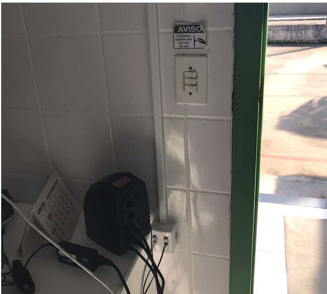
Figura 16: Rede lógica e elétrica separadas. (Fonte: Dos Autores 2020).
