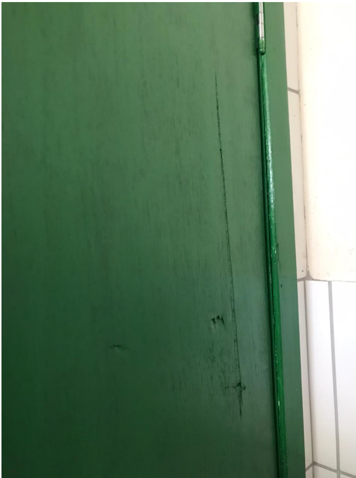
Figura 22: Porta com rachaduras por baixo da tinta. (Fonte: Dos Autores 2021).
