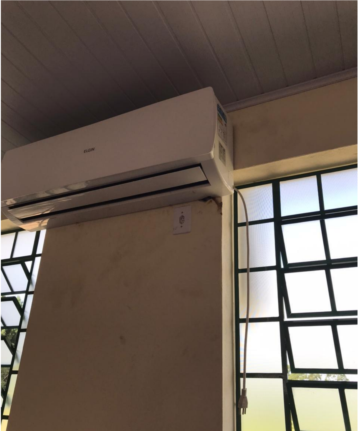
Figura 17: Ar condicionado em sala de aula. (Fonte: Dos Autores 2021).
