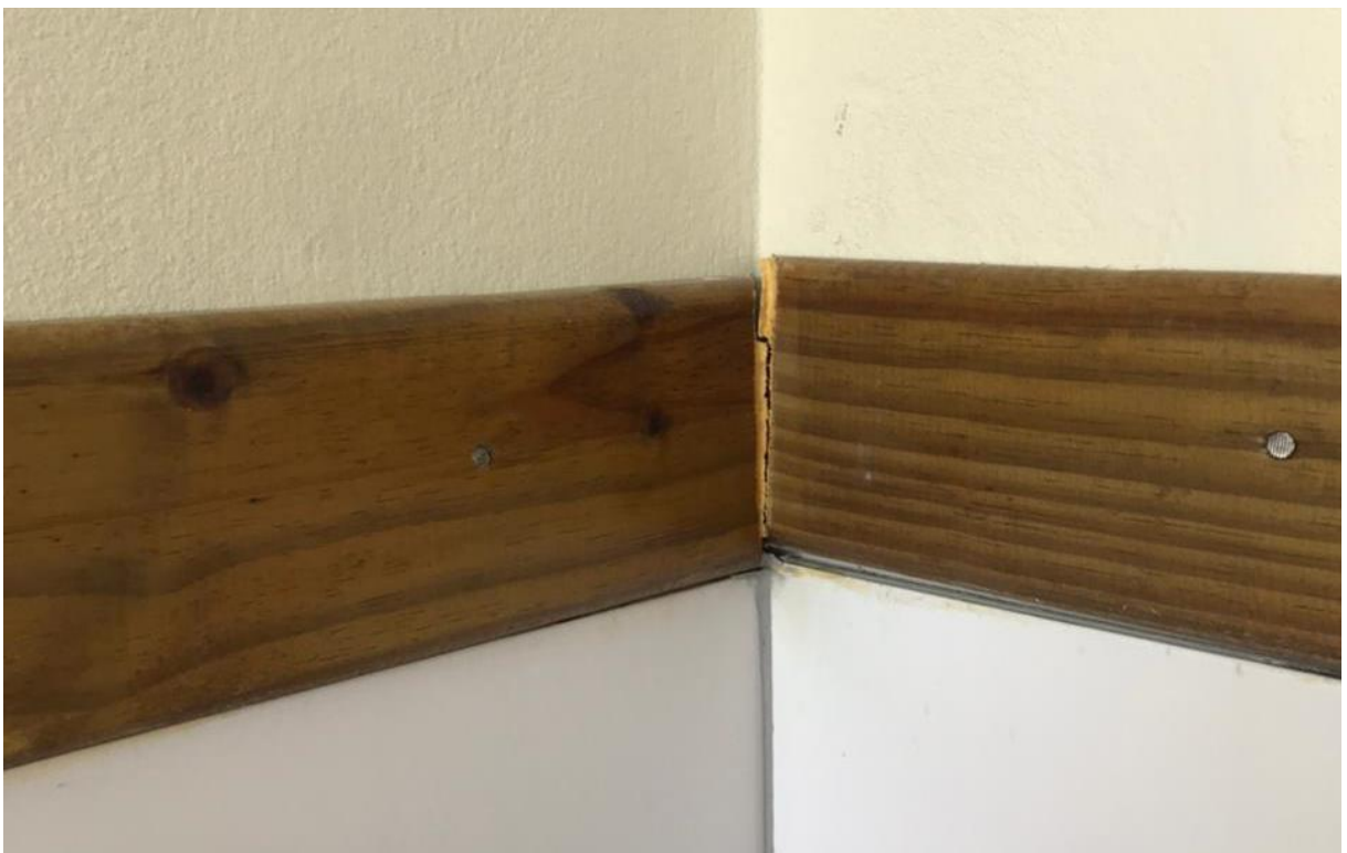
Figura 16: Faixas de madeira desniveladas. (Fonte: Dos Autores 2021).
