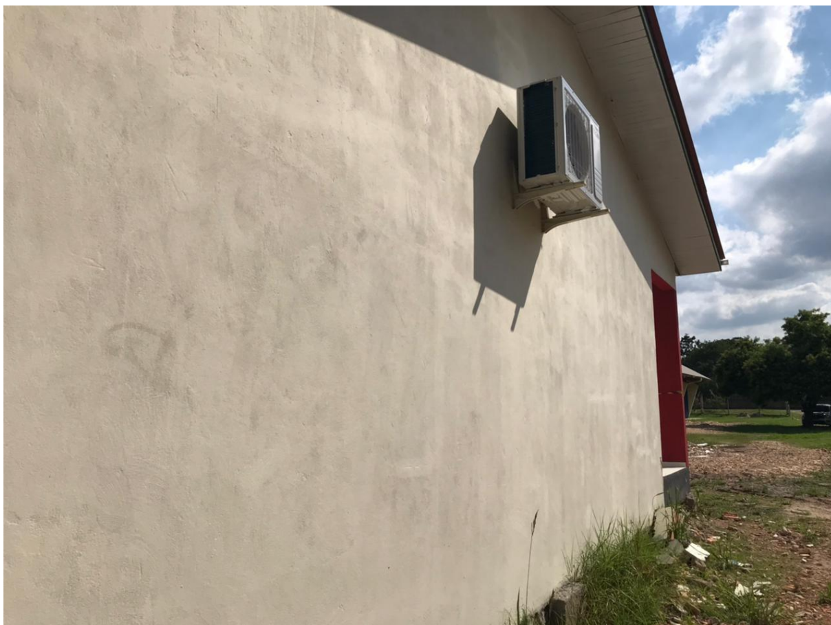
Figura 9: Reboco mal finalizado. (Fonte: Dos Autores 2021).
