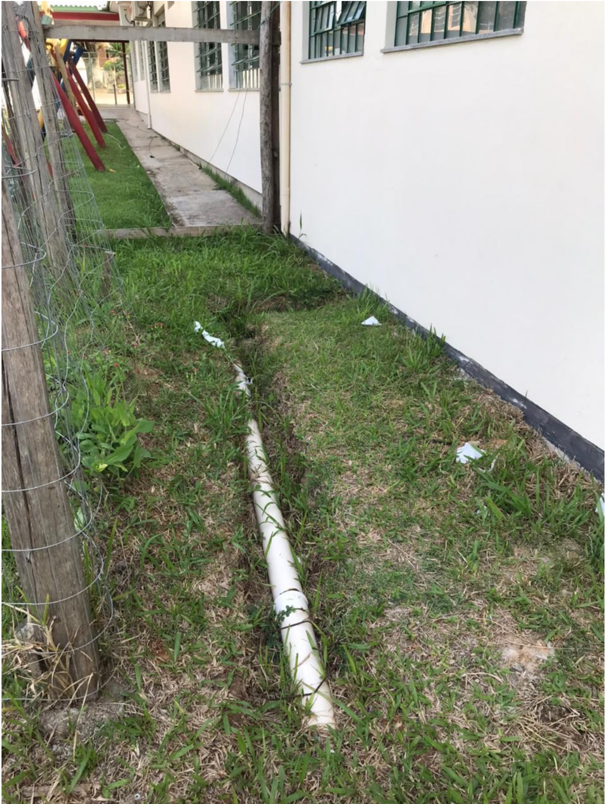
Figura 8: Encanamento exposto. (Fonte: Dos Autores 2021).
