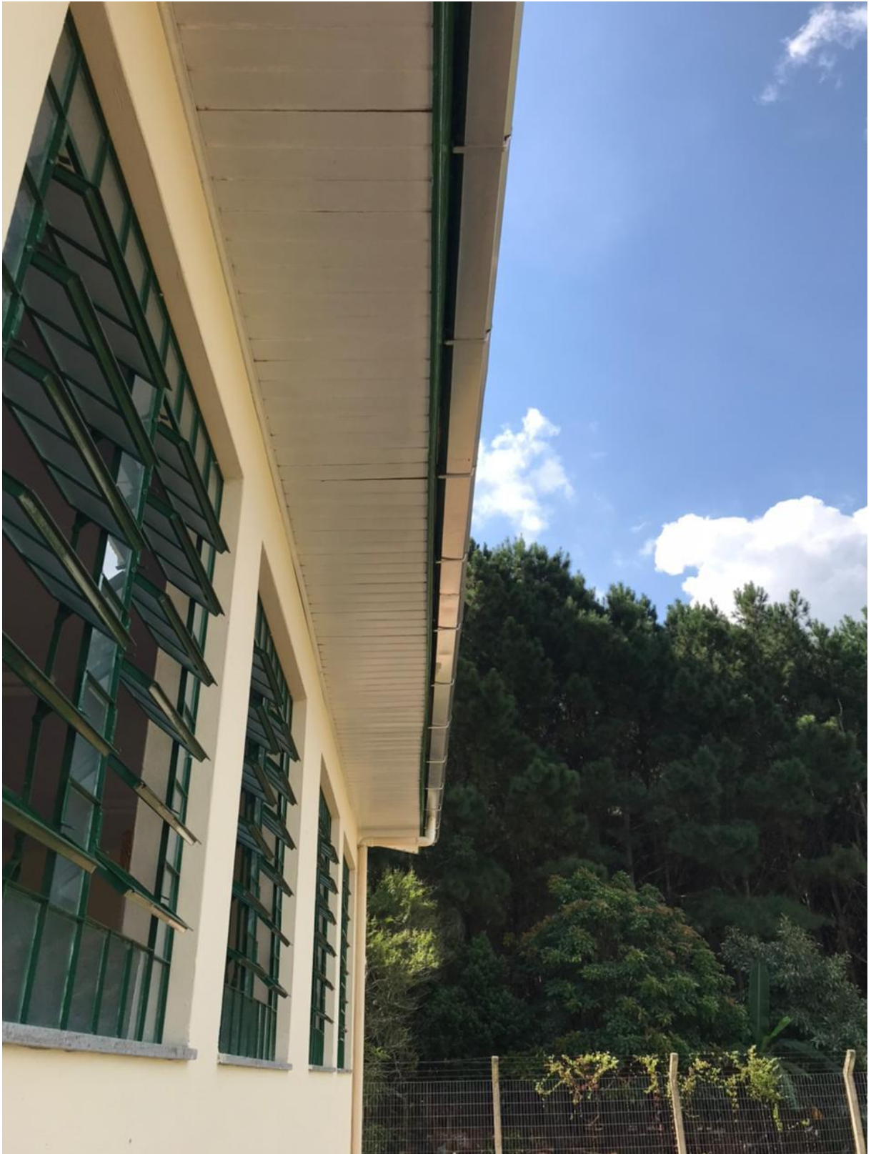
Figura 11: Forro mal finalizado. (Fonte: Dos Autores 2021).
