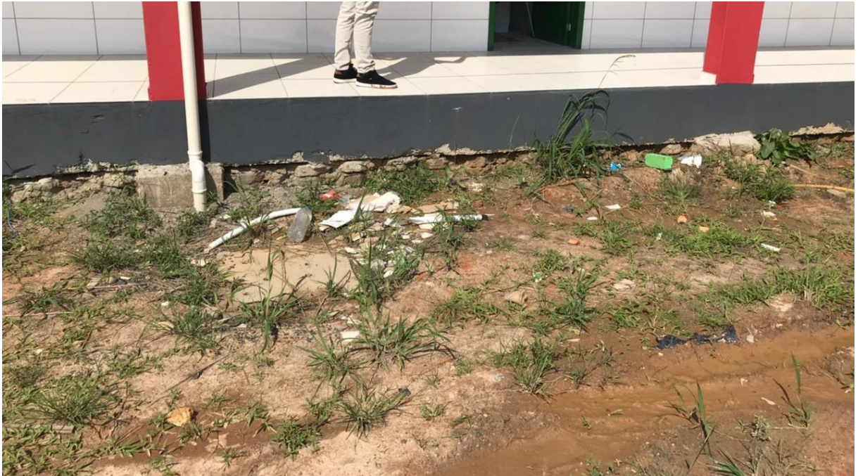
Figura 6: Base da edificação com péssimo acabamento. (Fonte: Dos Autores 2021).
