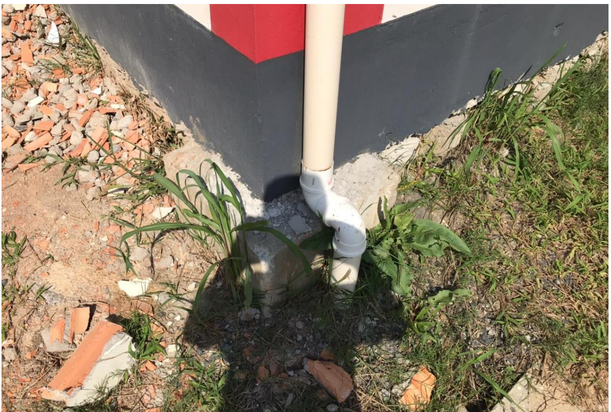
Figura 7: Base da edificação com péssimo acabamento e restos de entulho. (Fonte: Dos Autores 2021).
