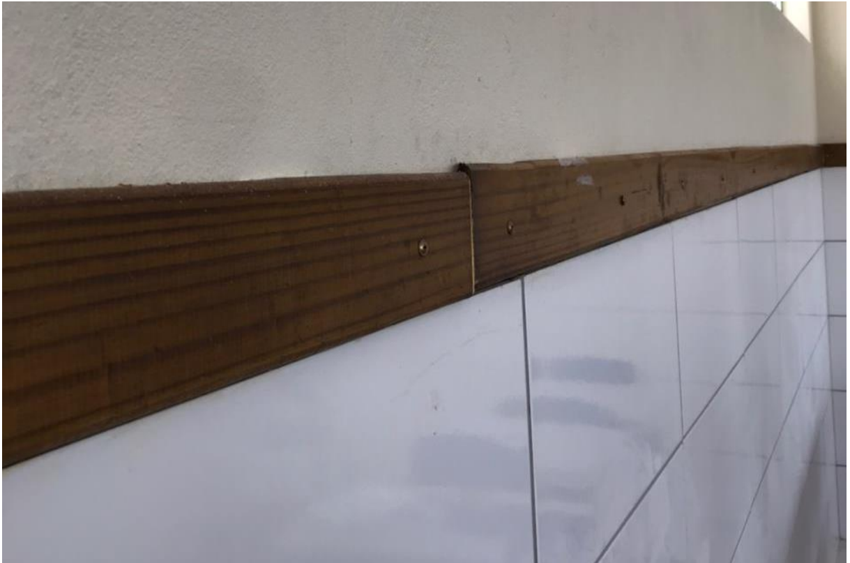
Figura 15: Faixas de madeira desniveladas. (Fonte: Dos Autores 2021).
