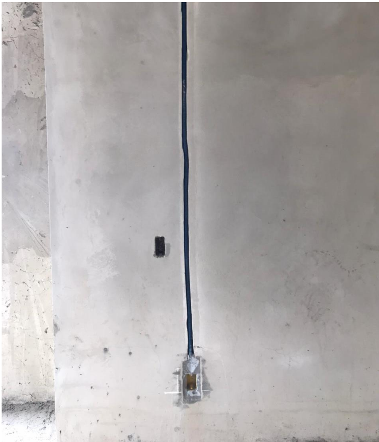
Figura 14: Eletroduto para passagem de fios. (Fonte: Dos Autores 2021).
