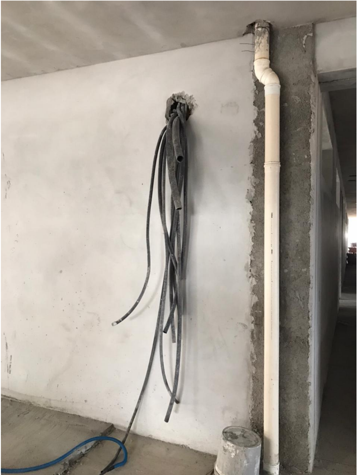
Figura 15: Tubos/canos elétricos e hidráulicos. (Fonte: Dos Autores 2021).
