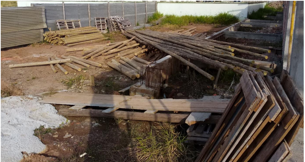
Figura 7: Materiais armazenados de forma incorreta (fonte: dos autores 2021).
